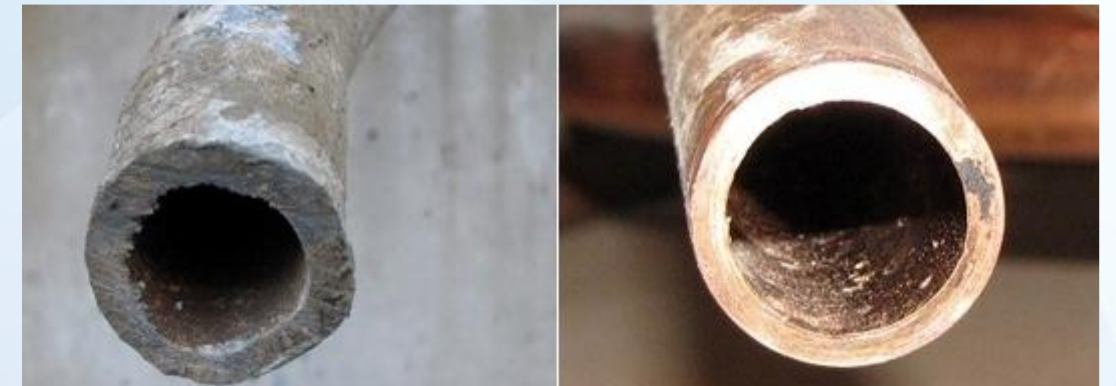
Conduite en plomb (à gauche)
