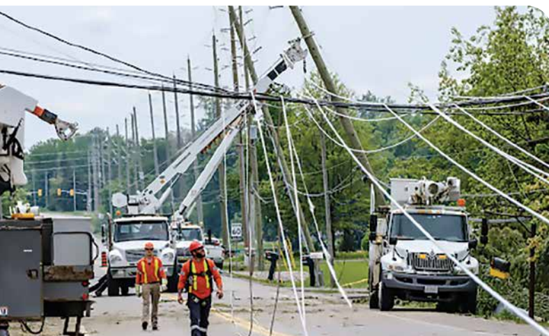
Image 3 : Dommages causés par la tempête
