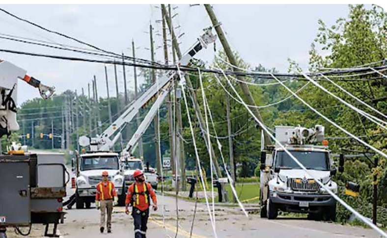
Image 3 : Dommages causés par la tempête
