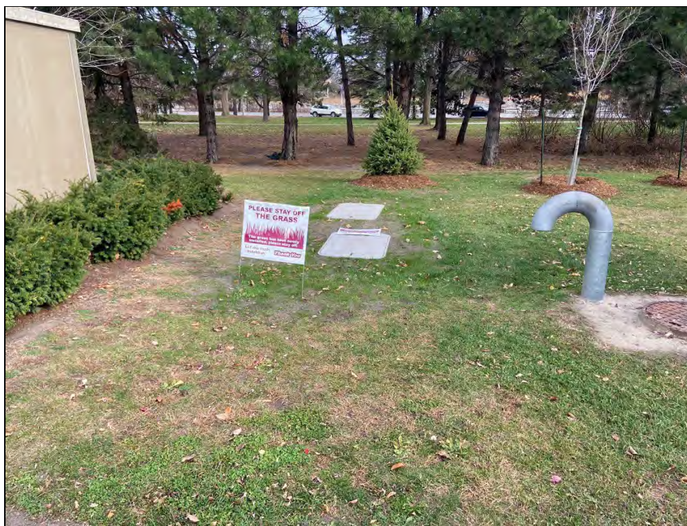
Photo 15 : Ancienne décharge est : Les récents travaux d'excavation menés pour installer les caissons en sous-sol pour le raccordement des services publics ont perturbé le couvert végétal à l'est du jardin pour enfants.
