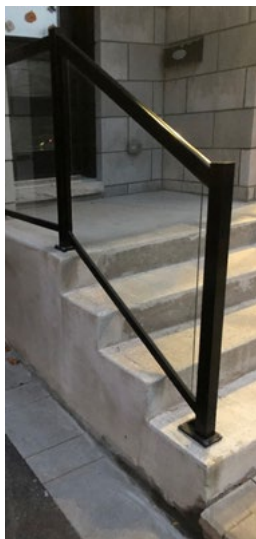
Exemple 1 – Garde-corps composé d'un panneau de verre avec un support supérieur et inférieur continus.
