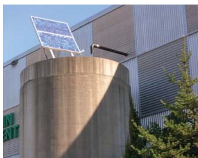
CITERNE PLUVIALE/PANNEAU SOLAIRE
