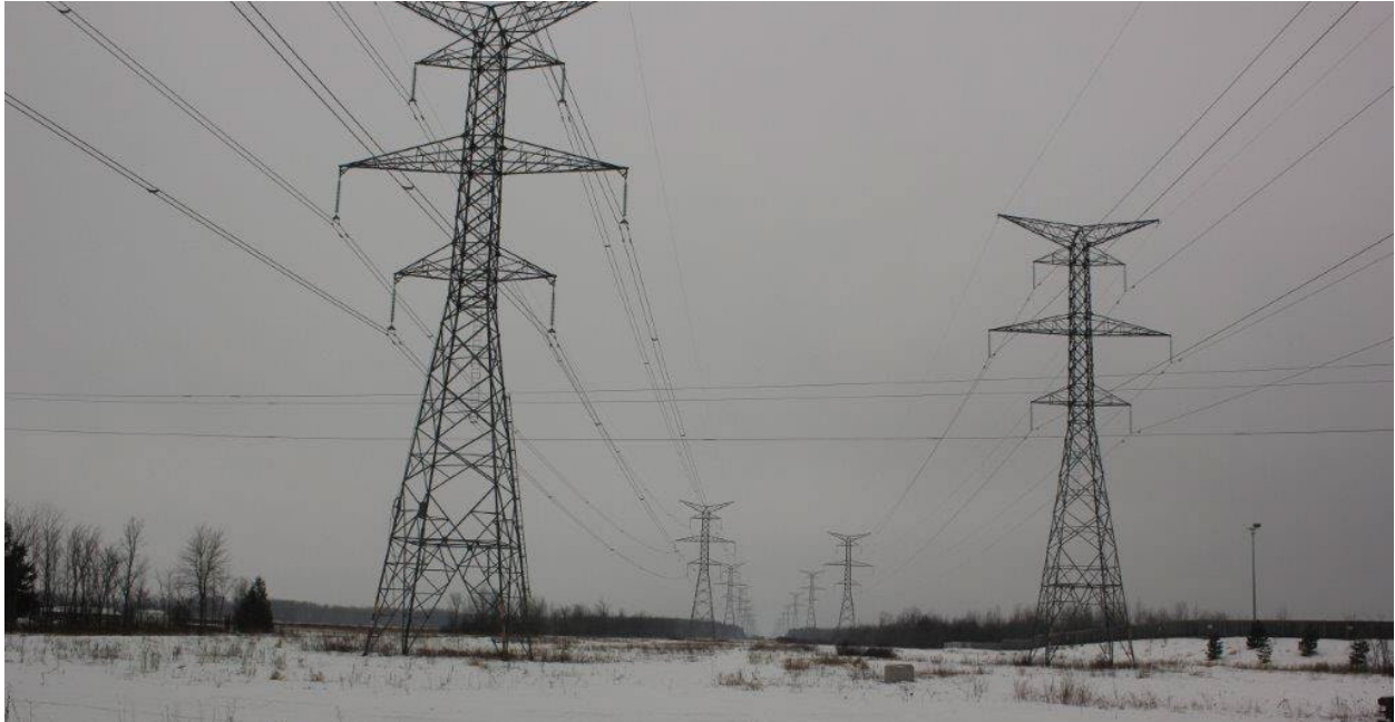
Figure 2. Couloir de transport de l'électricité
