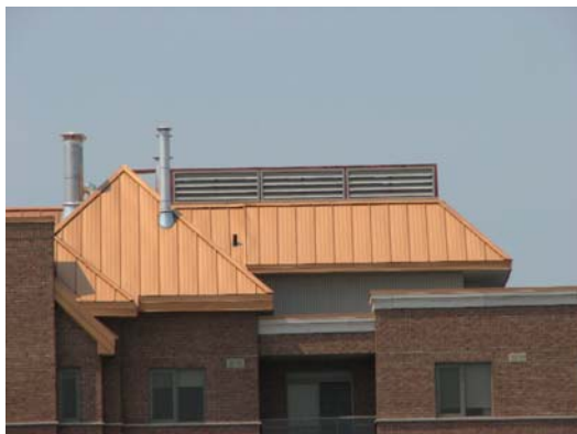
Figure 64b : Cet équipement mécanique de toiture est bien intégré dans cet immeuble d'appartements.
