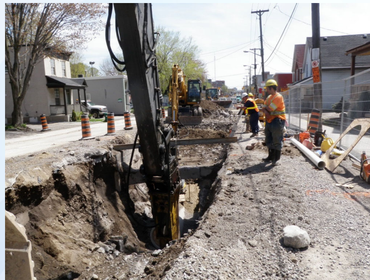
Installation des conduites d'égout sur une voie de circulation et accès piétonnier
