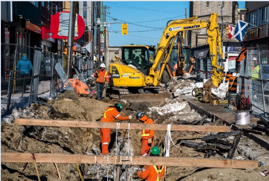
Travaux en sous-sol en faisant appel à des poutres pour étayer les câbles de services publics
