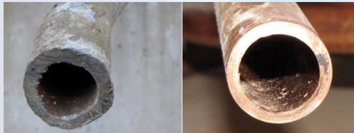
Conduite en plomb (à gauche) et conduite en cuivre (à droite)
