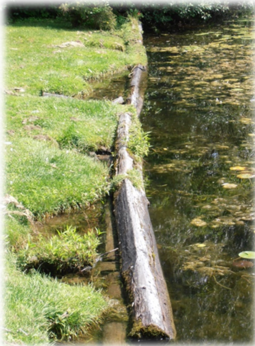
Avant : Mur de soutènement endommagé et érosion active
